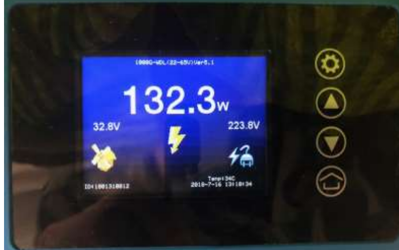
Betriebsdatenanzeige des SkyWind Wechselrichters
